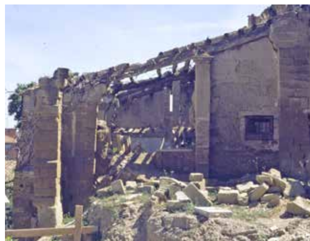
Sala de los machones con un piso encima de donde hubo arcos (Foto ANM, 1996)
